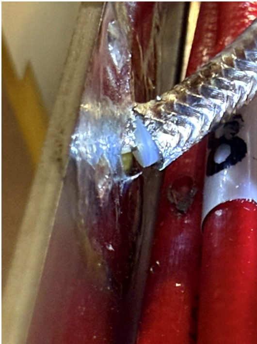
Internal Cable Fatigue
